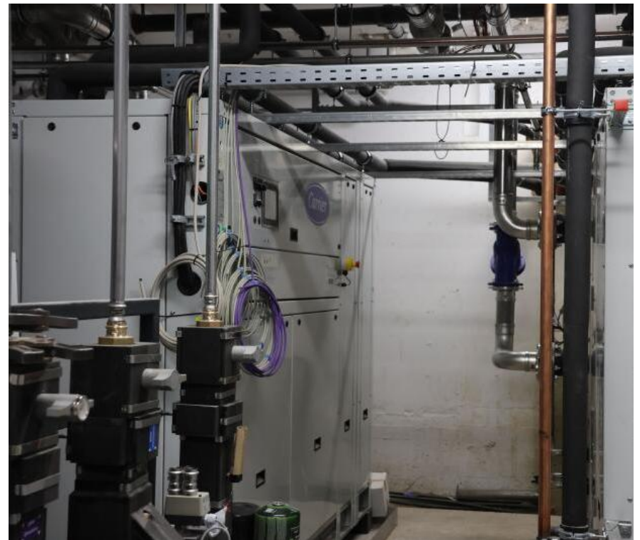
Blick in den „Maschinenraum“: Die neue Wärmepumpe erzeugt emissionsarm Wärme für das Hallenbad.
